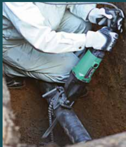
埋設管の切断
