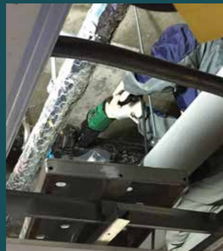
天井裏の排水管切断
